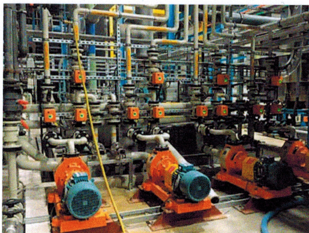
Les entreprises de Jean-Paul Jackers ont fourni aussi bien les pompes, les vannes que les accessoires.
